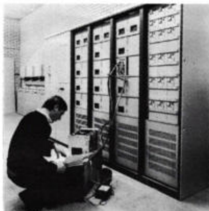
Inbedrijfstelling licht sterke regelaars, back-up systeem en aardfoutbewaking van één van de baanstations voor een stof- en landingsbaan NV Luchthaven Schiphol.
